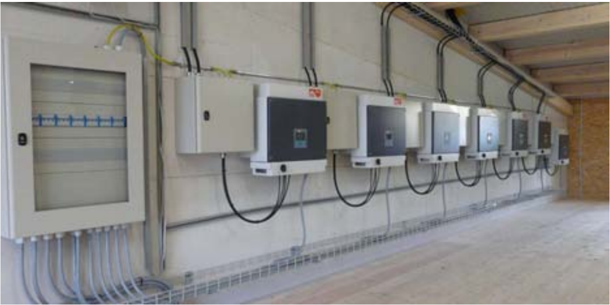
Refusol Wechselrichter im Bürogebäude...
